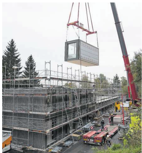
Ein Modul für das Grenzhof-Schulhausprovisorium wird vom Kran in die Höhe gehievt. Bild: Boris Bürgisser (Luzern, 25. Oktober 2019)
