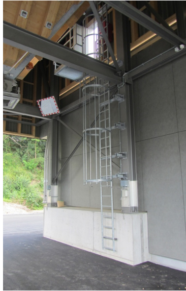
Doppelmodulsilo mit Photovoltaikanlage
