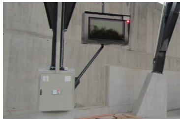
Hopperförderanlage mit Klappe
