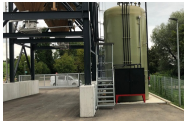
Seitliche Ansicht der Siloanlage in Uhingen
