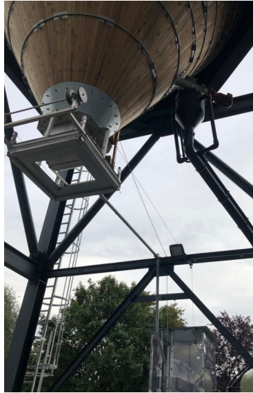
Automatisierte Soleanlage mit Lagertank
