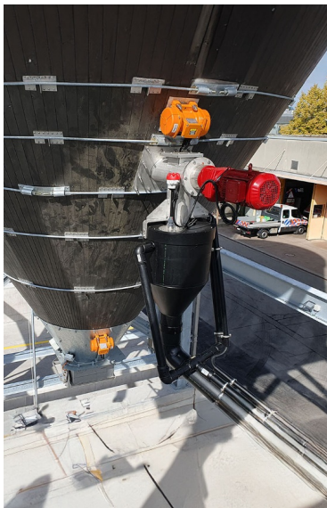
Réservoir de saumure avec poste de commande
